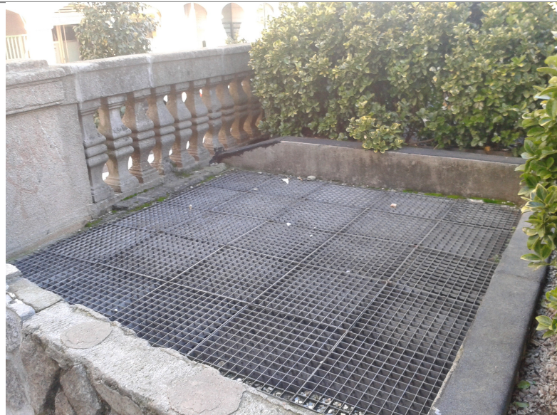
FOTO N°9: Saída de ventilación forzada a través dun patinillo cara ó nivel da Praza de Portugal.
