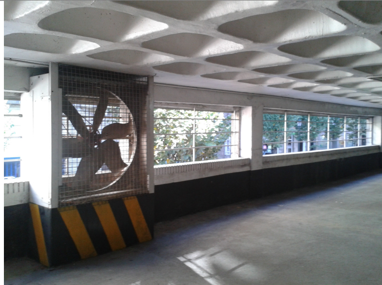
FOTO N°8: Ventiladores coma reforzo da ventilación natural na planta -1.
