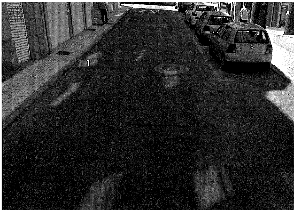
Rúa Progreso. Foto nº2. Descarnaduras
