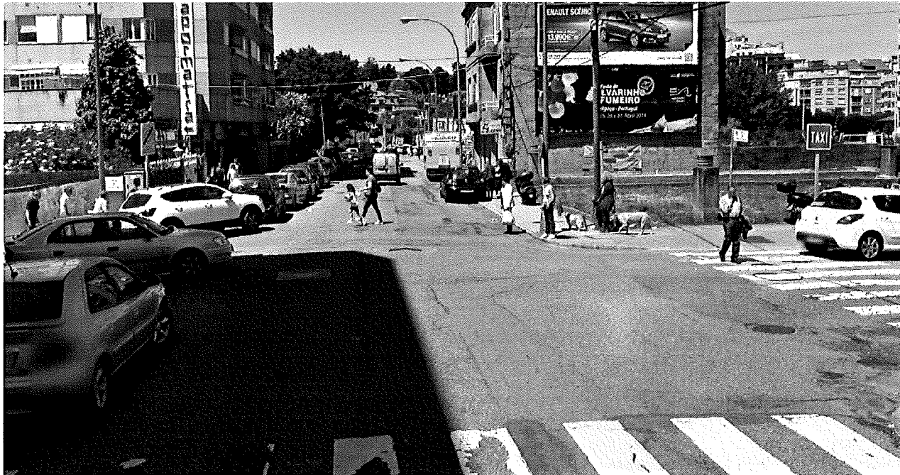
Rúa Puerto Rico. Foto nº1. Roderas y ascensión de finos
