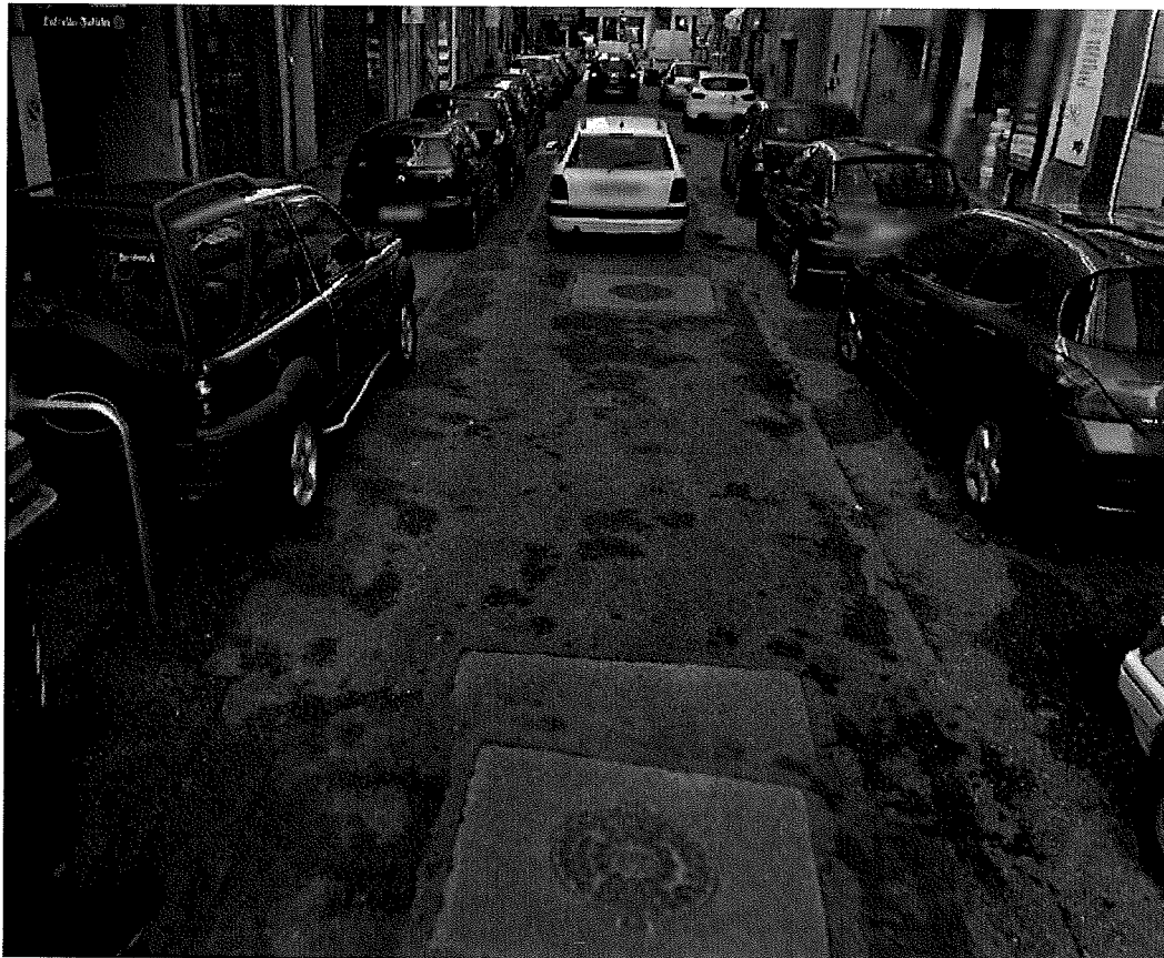
Rúa Manolo Martínez. Foto nº2. Grietas y descarnaduras
