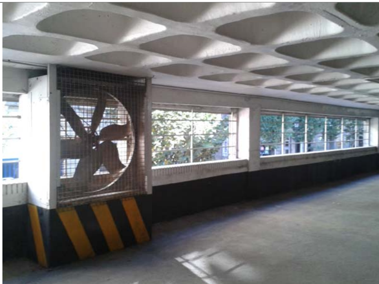
FOTO Nº8: Ventiladores como refuerzo de la ventilación natural en la planta -1.
