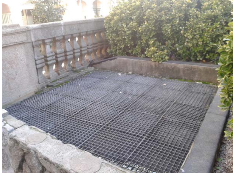
FOTO N°9: Salida de ventilación forzada a través de patinillo hacia el nivel de la Plaza de Portugal.
