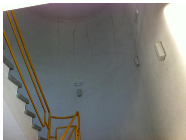
Grietas a reparar
