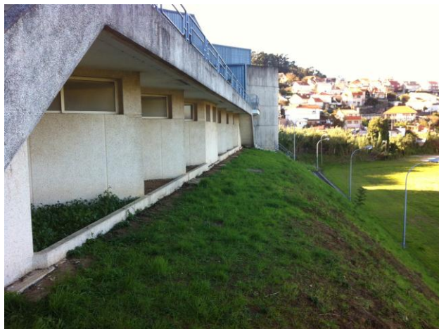
Ambos accesos de la fachada Norte carecen de comunicación
