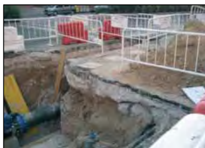
Acopio en borde de excavación, Provocando una sobrecarga estática.
