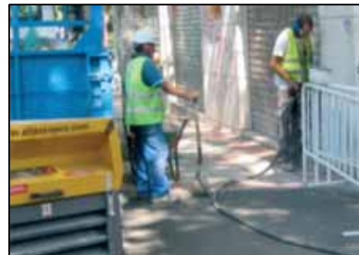
Posición correcta del trabajador, puesto que mantiene una cierta distancia.
