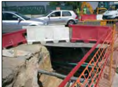
Apoyo comprometido en zona con intenso Tráfico que podría provocar su deslizamiento.
