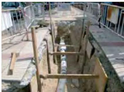
Sujeción de paredes de la zanja mediante Tableros horizontales y velas apuntaladas por codales.
