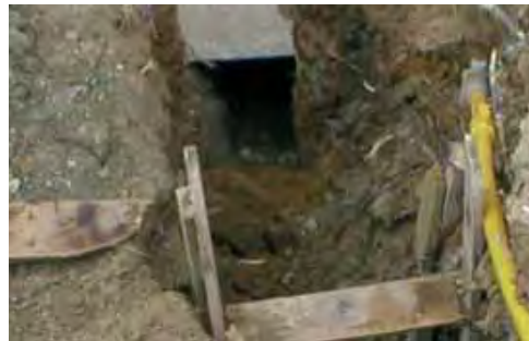
Solución incorrecta e improvisada que no otorga ninguna garantía. El personal que lo realice debe Disponer de formación y experiencia contrastada.
