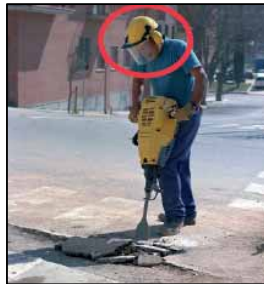
Utilización correcta de pantalla de protección durante operaciones demolición con medios mecánicos.
