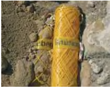
Cinta de señalización de gas
