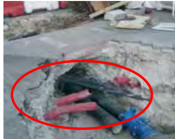
Rotura de los conductos de protección
