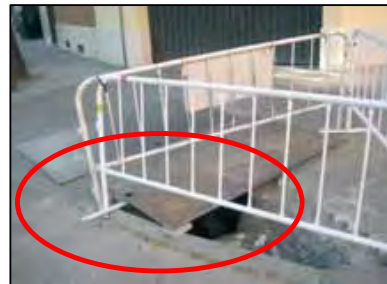
Apoyo inestable de la chapa
