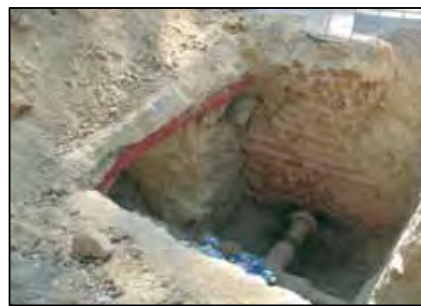
Acopio en borde de la cala, provocando una sobrecarga estática.
