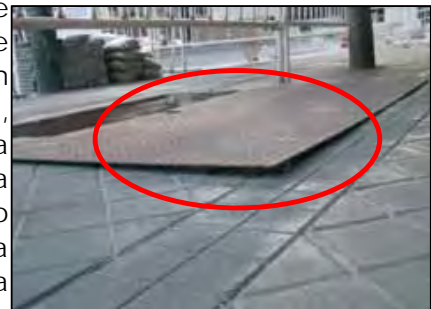
Chapa con las puntas levantadas, que puede dar lugar a accidentes de peatones
