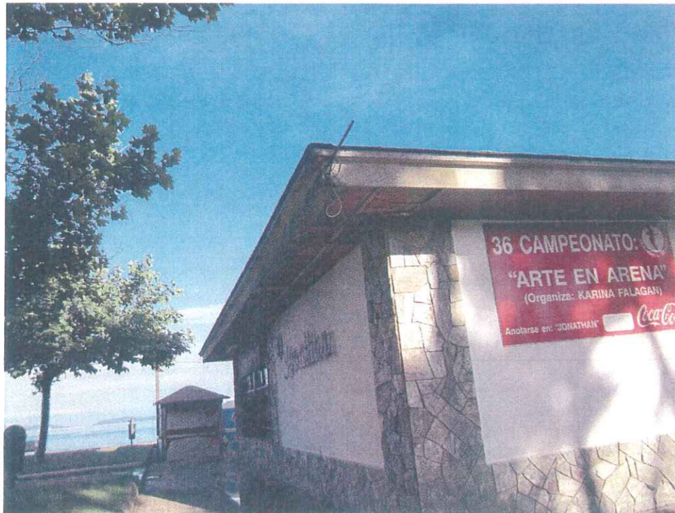
Detalle do estado actual do alero da cuberta.
